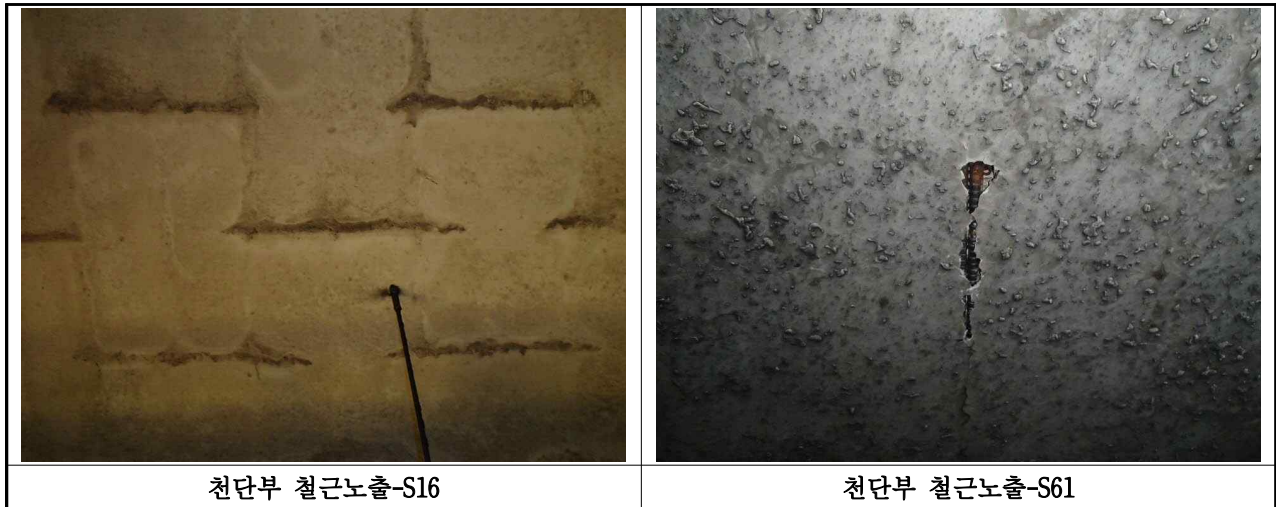
【사진 1.1.3】 라이닝 외관조사 결과(3)
