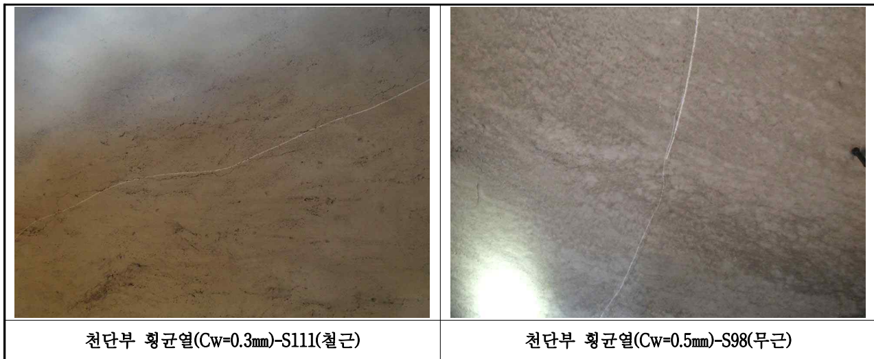
【사진 1.1.2】 라이닝 외관조사 결과(2)
