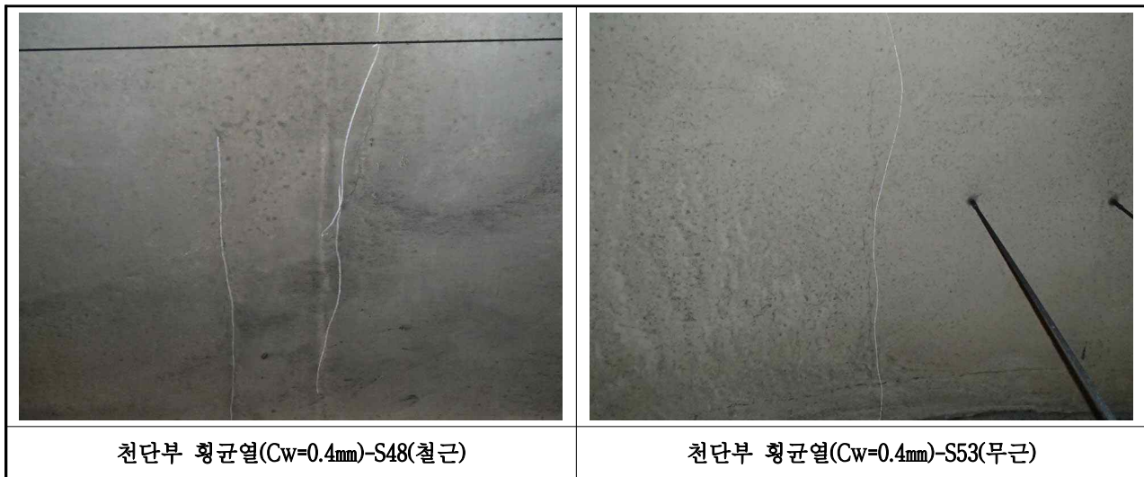
【사진 1.1.2】 라이닝 외관조사 결과(2)
