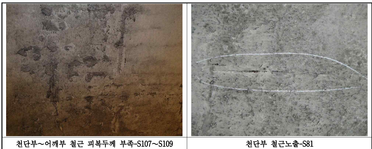
【사진 1.1.4】 라이닝 외관조사 결과(4)
