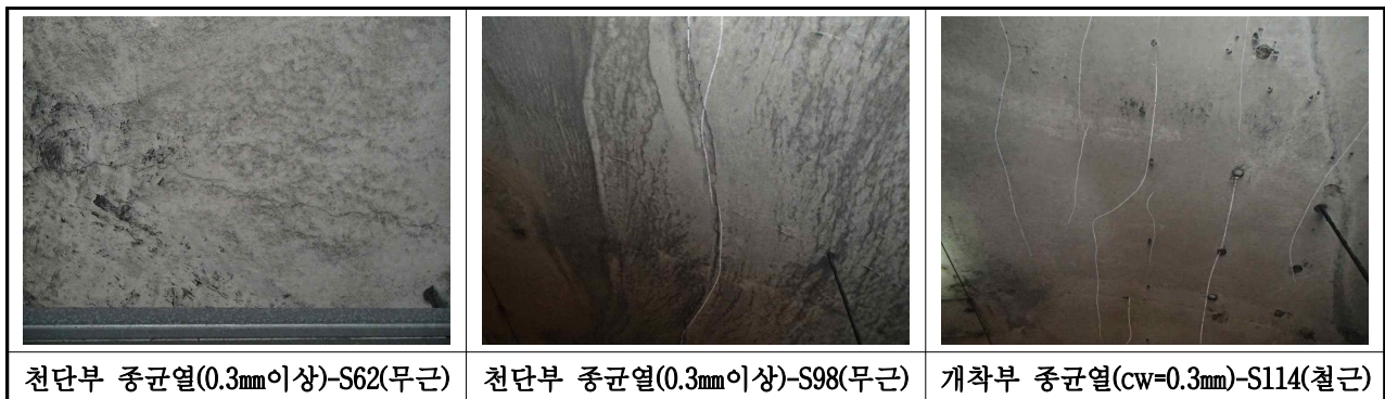
【사진 1.1.1】 라이닝 외관조사 결과(1)
