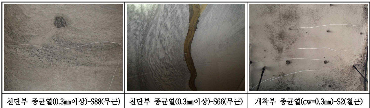
【사진 1.1.1】 라이닝 외관조사 결과(1)
