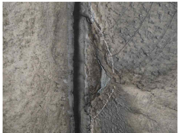
신축이음부 들뜸-S27, 천단부
